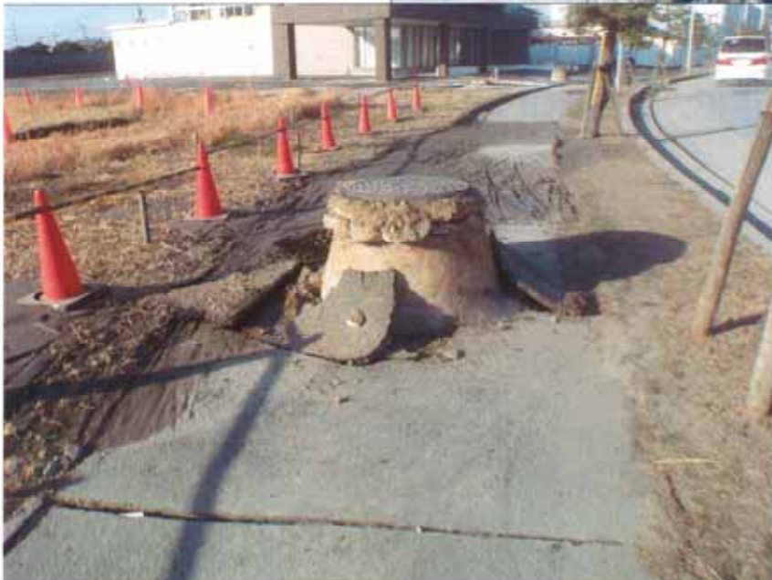
マンホールが飛び出しています
