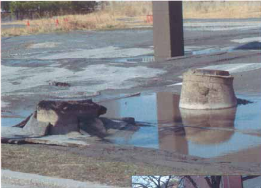
マンホールが飛出ています
