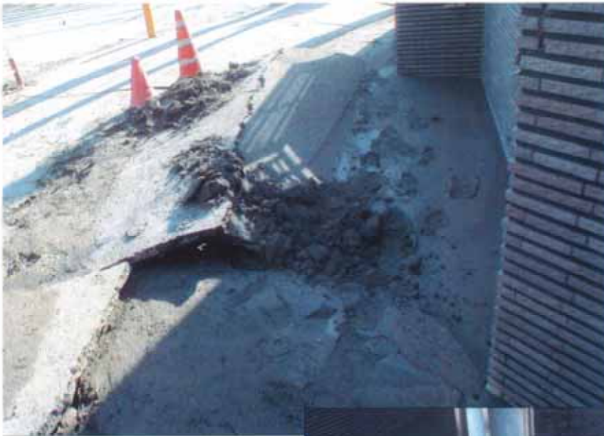
液状化で砂が噴出しています
