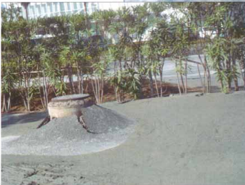
マンホールが飛出ています
